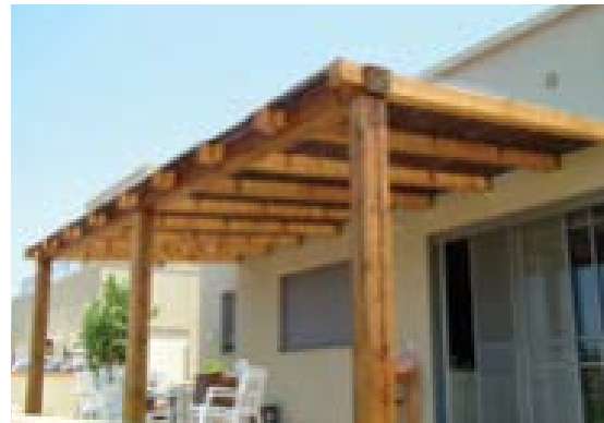
דוגמאות למצללות התואמות את התקנות על פי היחס שבין השטח הפתוח לשטח האטום
